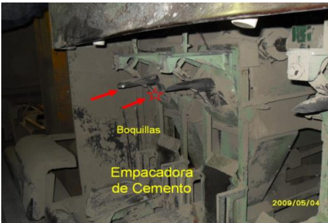
Fotografía 5. Boquilla de la Maquina Ensacadora.
