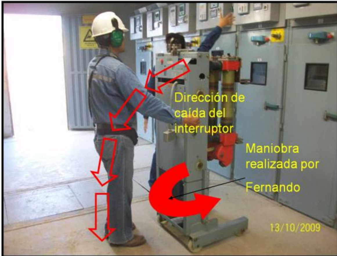
Fotografía 7. Interruptor de media tensión de la subestación principal.
