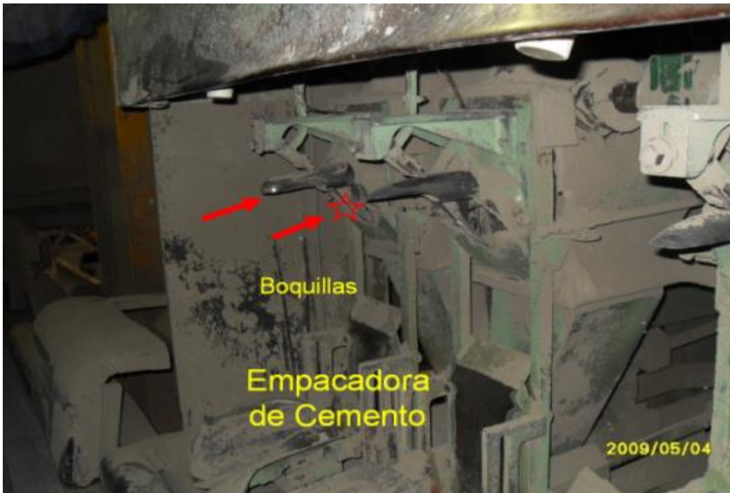
Fotografía 5. Boquilla de la Maquina Ensacadora.
