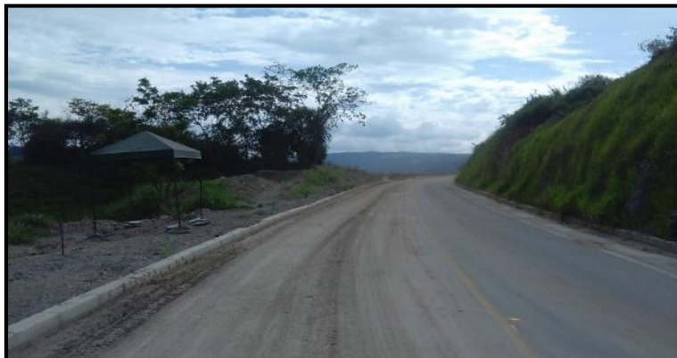
Imagen 13. Acumulación de material sobrante de excavación en la vía
