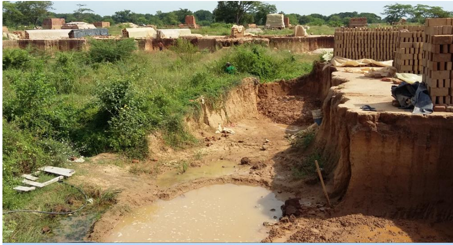
Ilustración 8. Falta de desagüe
