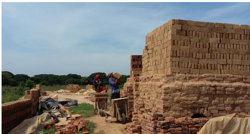
Ilustración 5. No elementos de protección personal (EPP)
