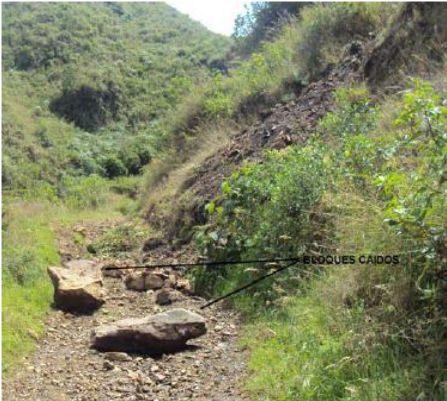
Figura 17. Caída de bloques, Vereda Cerro el Tesoro.
