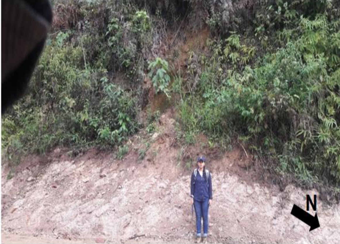
Figura 44. Talud que presenta nivel de amenaza media.
