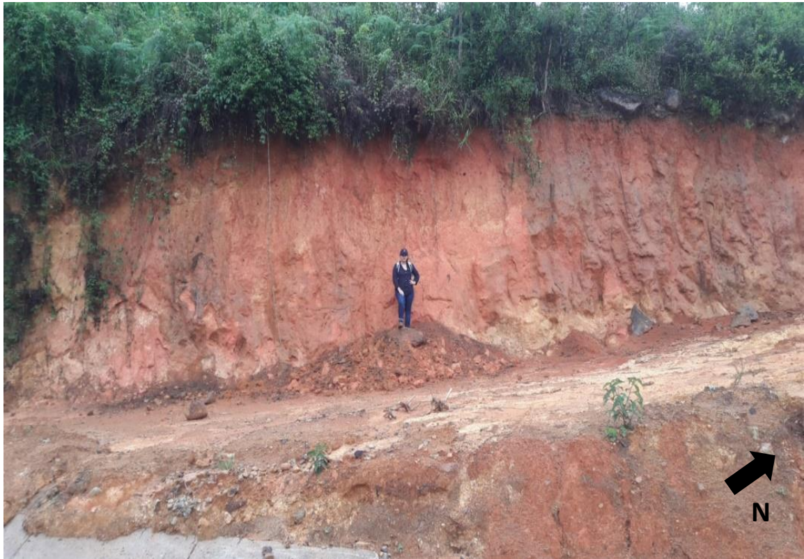
Figura 43. Talud que presenta nivel de amenaza muy baja y baja.
